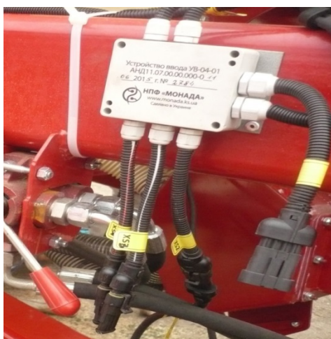
Рисунок 8. Розподільний блок системи контролю
